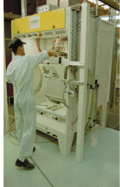
Das Pulver-Wechselzentrum versorgt 4 Pistolen mit zurückgewonnenem und 5 mit Frischpulver
