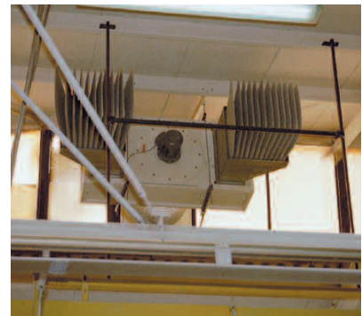
Einfach, ökonomisch und wirkungsvoll: Frischluft wird dezentral über Taschenfilter in die Halle gedrückt
